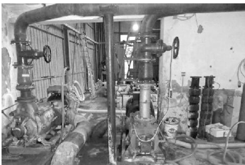
Lo stato delle condutture di Santa Filomena parla da solo (mm)
